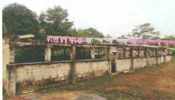
Foto1: Sin Techo, se necesita una cubierta de lamina
