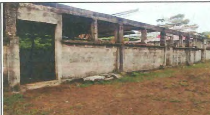
Foto 3: sin puertas, se necesita nuevas puertas.
