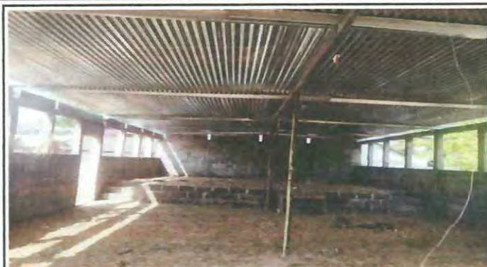
Foto 2: sin estructura formal de techo, es necesario una formal.
